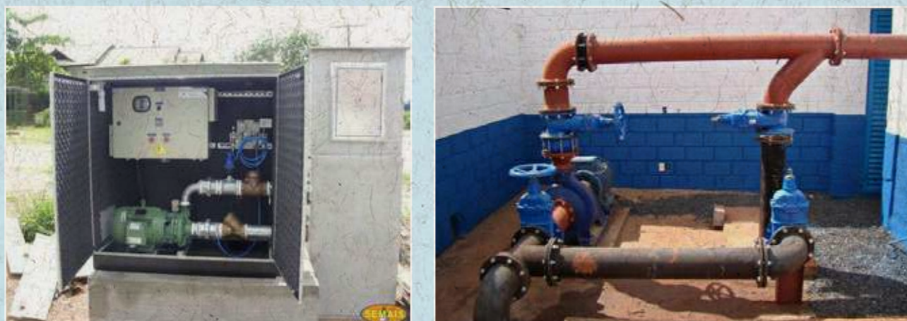
Figura 5 – Estações Elevatórias (típica e pressurizada)
